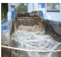
Figura 1. Unidad de coagulación planta de tratamiento
